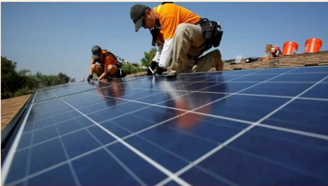
Instalación de autoconsumo solar sobre tejados | Invertia
